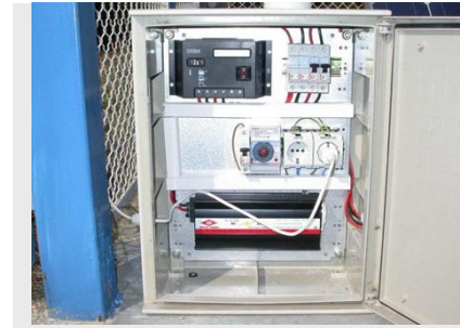
Στεγανός πίνακας IP65 με ρυθμιστή φόρτισης, inverter, ασφάλειες, χρονοδιακόπτες για εξωτερική τοποθέτηση
